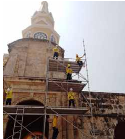
Consolidación de grietas y fisuras
