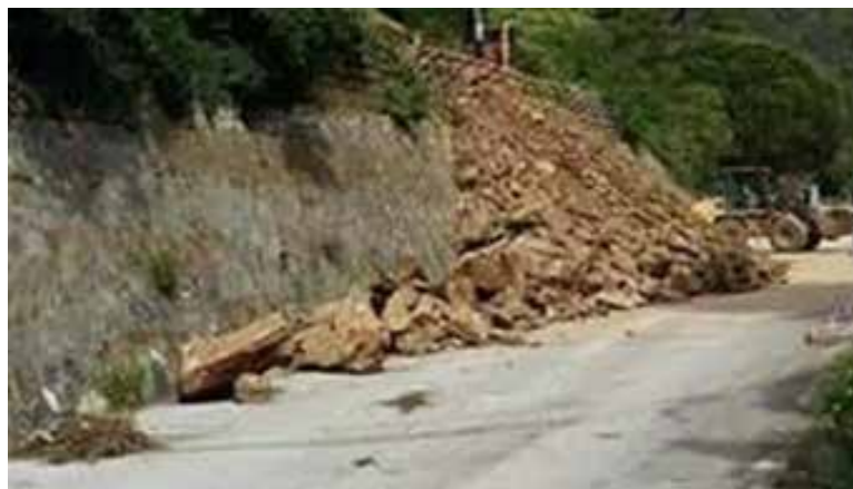
Figura 13. Esempi di danneggiamenti causati dalla frana del 2016
