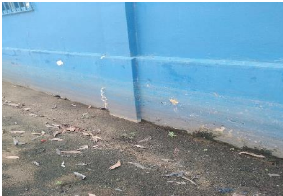
Image 11 : Les traces laissées sur les murs du Médico scolaire par les eaux d'inondation (Zone résidentielle)
