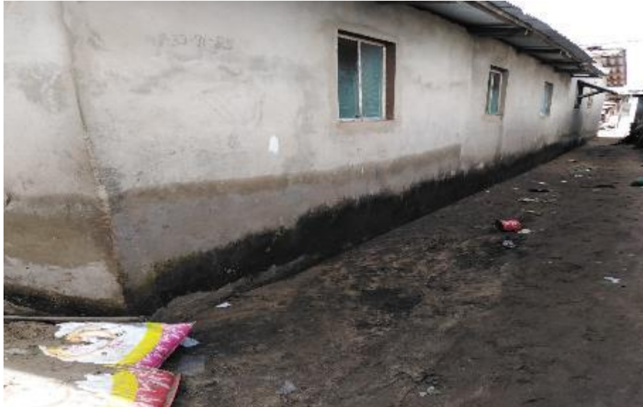
Image 10: Les traces laissées sur les murs des édifices par les eaux d'inondation (Village Nzima)
