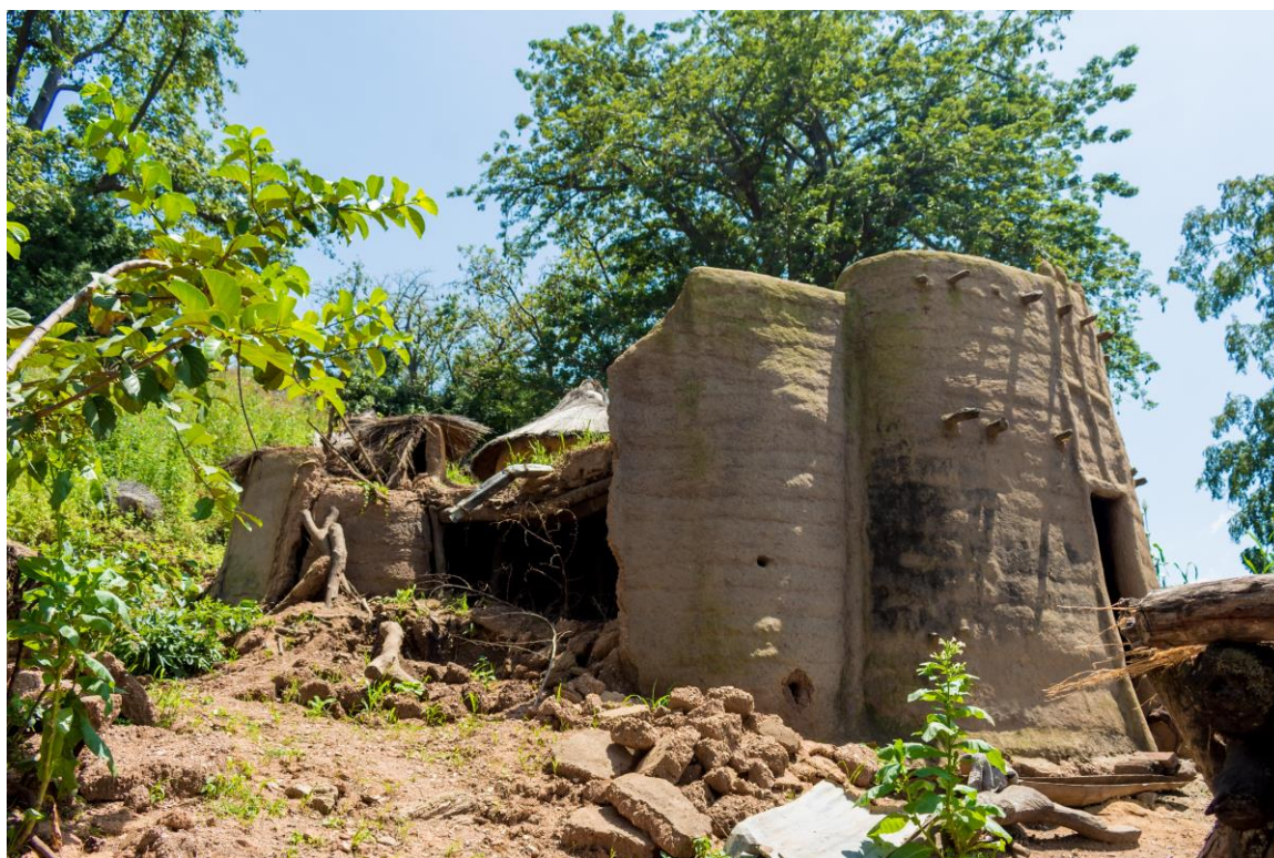
Takienta partiellement effondrée – notons le tuyau en tôle insérée dans la dalle, octobre 2018 ©UNESCO/Banléman Kombaté
