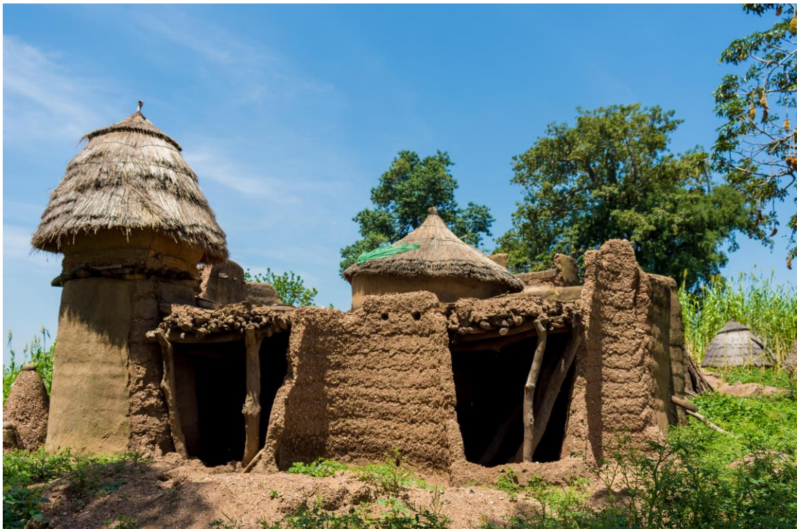
Takienta partiellement effondrée à Bassamba, octobre 2018 ©UNESCO/Banléman Kombaté
