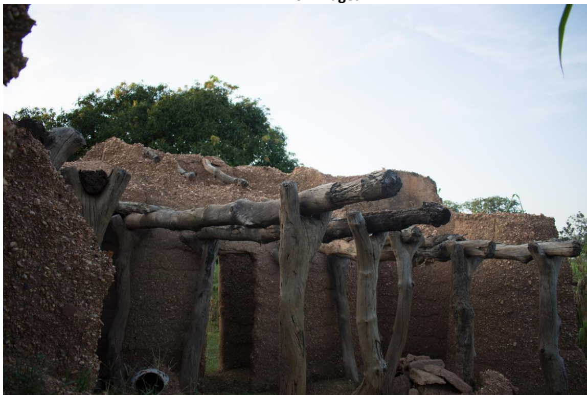
Poutres et piliers du bois exposés suite à l'effondrement des murs en terre, octobre 2018
