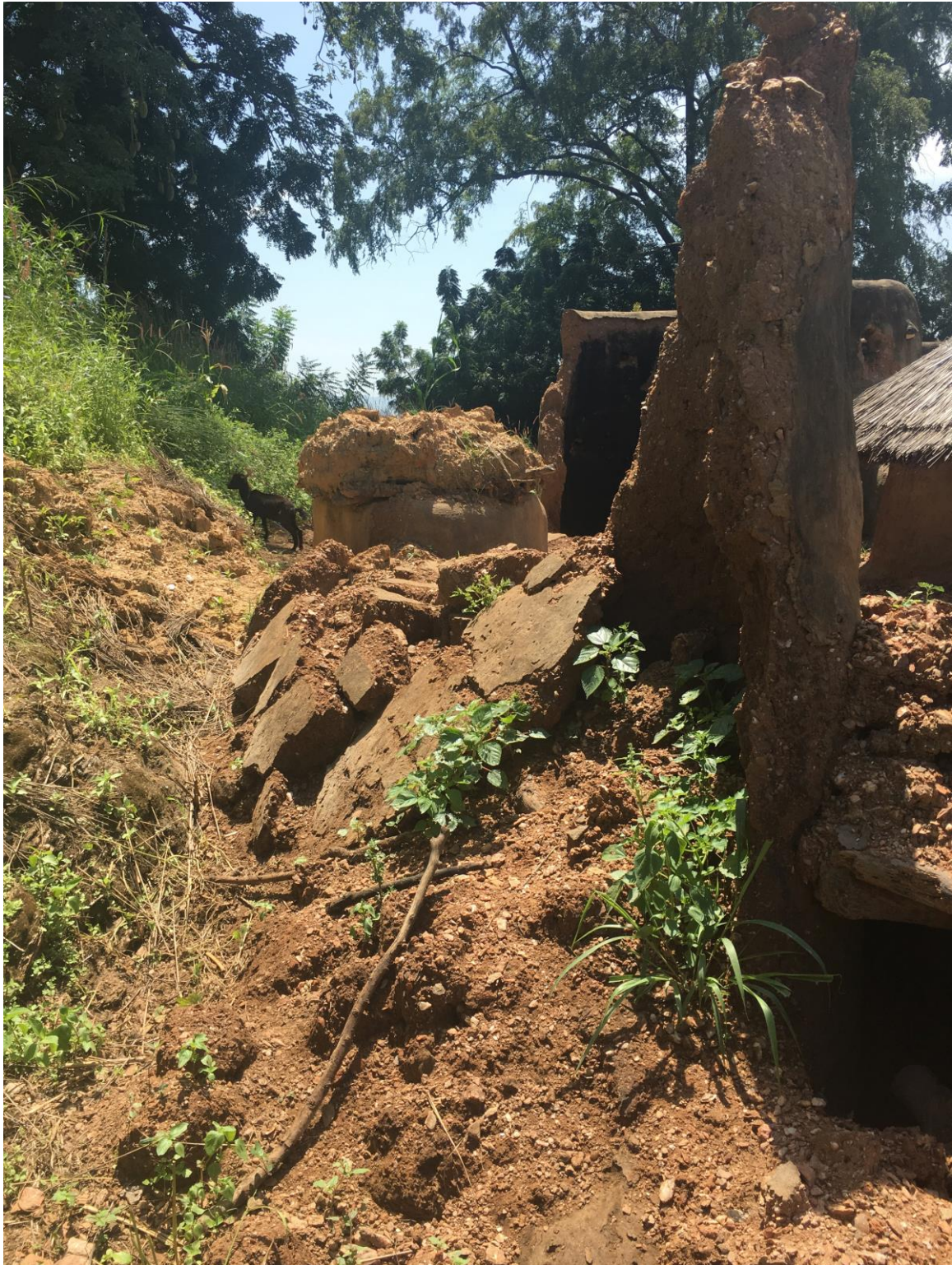
Mur de takienta effondré au bas de colline, octobre 2018 ©UNESCO/Ishanlosen Odiaua
