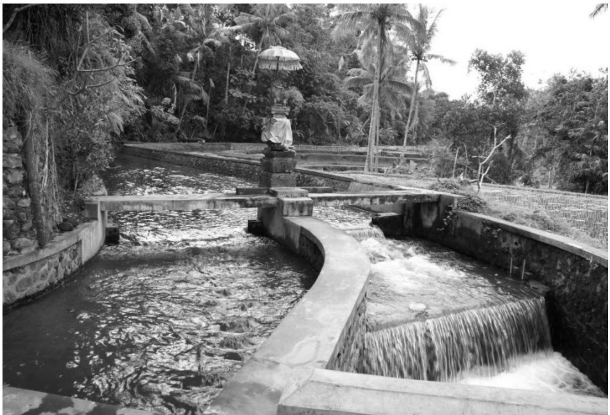
Canal d'irrigation principal de la source à Tirtha Empul, avec des ramifications vers Pulagan et Kulub Atas
