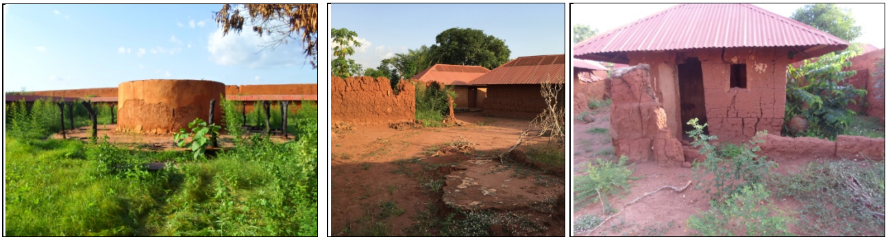
Adoho de Gbéhanzin détruit par l'incendie, Bâtiments dégradés du couvent Dossèmè
