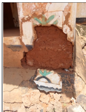
Divers dégradations (Aire muséale)
