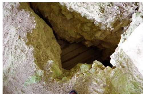
Figure 9: Batterie Coidavid - Voûte défailtante
