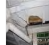
Deterioro en techo, filtraciones desde pendiente de revestimiento interior
