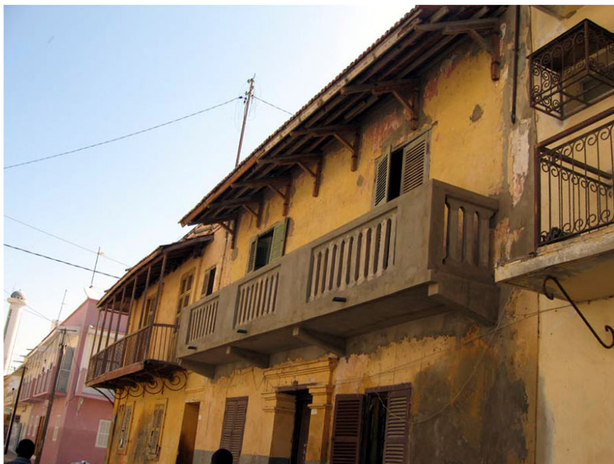
Une occasion manquée, un balcon déjà transformé, remaçoné selon un état tardif là où un retour à l'origine était nécessaire (travaux sans autorisation?)
