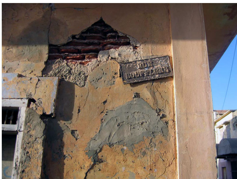
Exemples de dégradation, provoquant des fissures dangereuses
