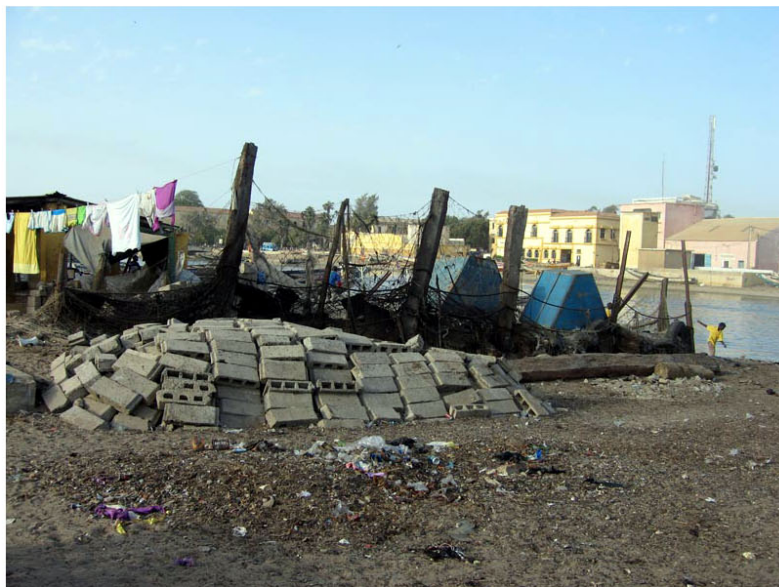
Sur la Langue de Barbarie chantiers anarchiques, surélévations, densifications
