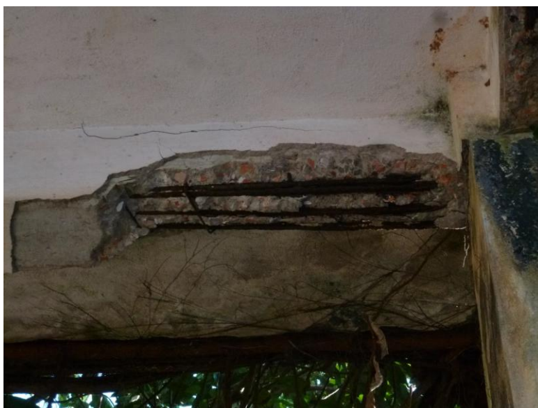
Figure 12 Poutre en béton armé support de la galerie du 1er étage : noter la présence d'éclats de terre cuite
