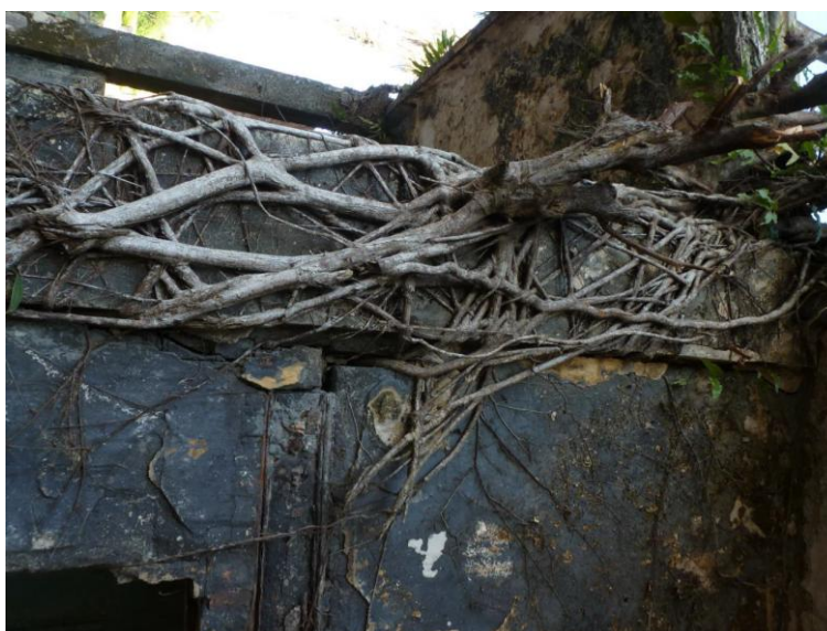
Figure 10 Frettage « naturel » d'une pile de rez-de-chaussée
