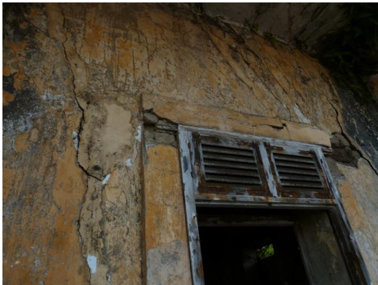
Figure 11 Noter le scellement des traverses des persiennes dans l'enduit
