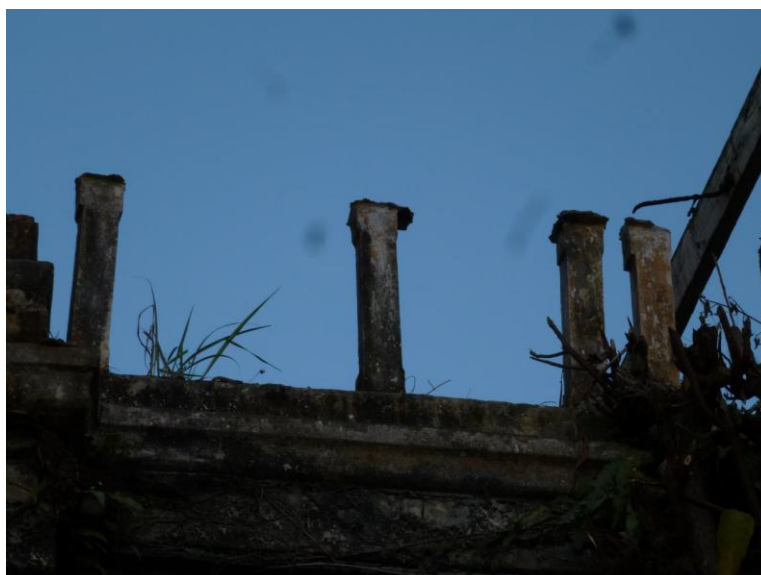
Figure 13 Vestige de balustres du 1er étage en ciment moulé
