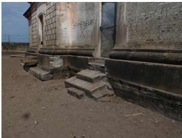
Figure 6 Phare : Fondement déchaussé
