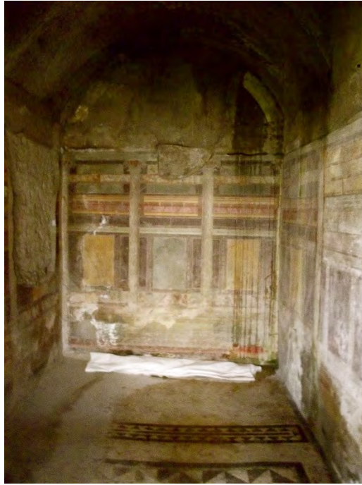
10 – Casa delle Nozze d'Argento (V, 1, i), cubiculum de Second style victime d'une fuite d'eau de pluie non maîtrisée.
