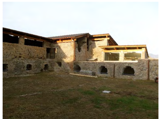
26 – Casa del Criptoportico (I, 6, 2), vue générale de la demeure depuis la terrasse méridionale. Aspect navrant d'un hangar agricole.
