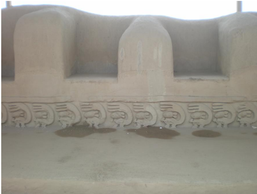
Figura 5.- Humectación de estructuras por precipitaciones pluviales.
