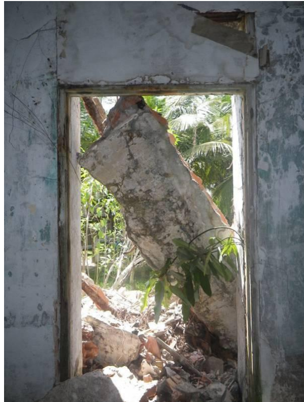
Effondrement d'une coursive de l'ancien tribunal de Grand Bassam – Photos FA 22.10.2013
