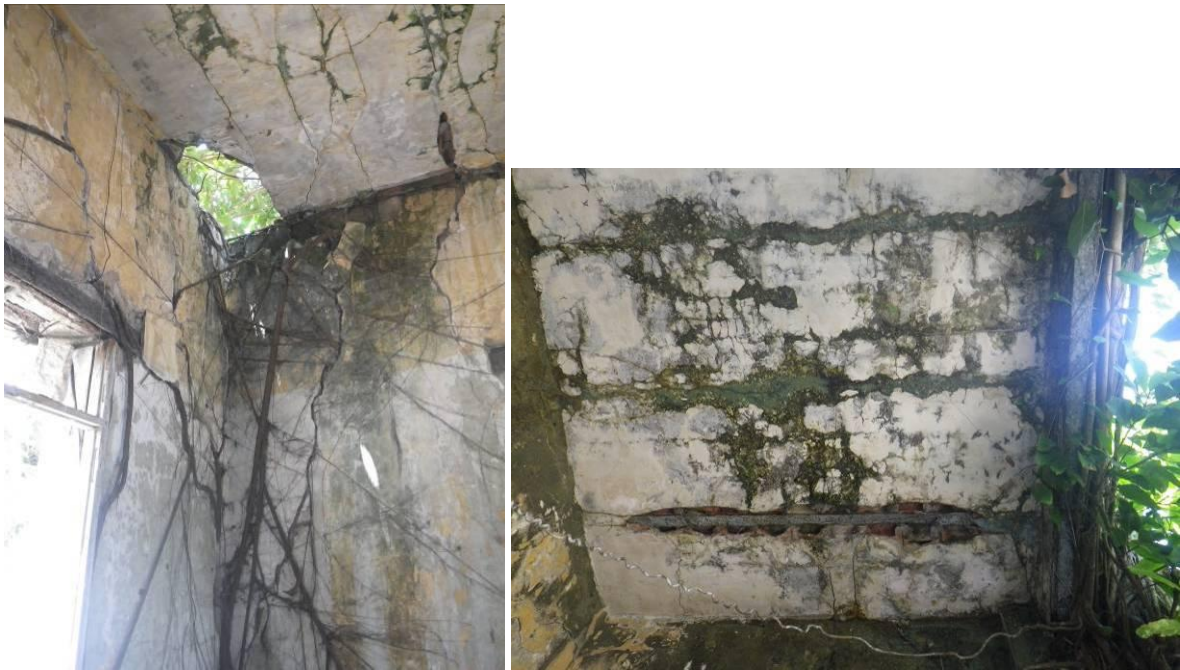
Dégâts structurels et corrosion des fers au Tribunal de Grand Bassam – Photos FA 22.10.2013
