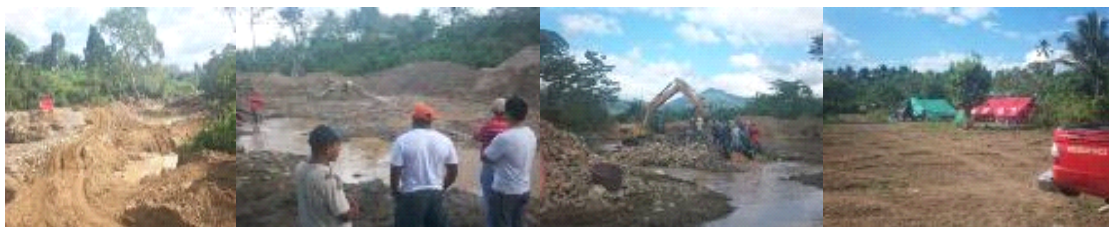
Ilustración 4 Extracción de oro en el río Paya utilizando maquinaria. En este sitio se denota altos impactos en el cauce del río debido a la remoción de suelo
