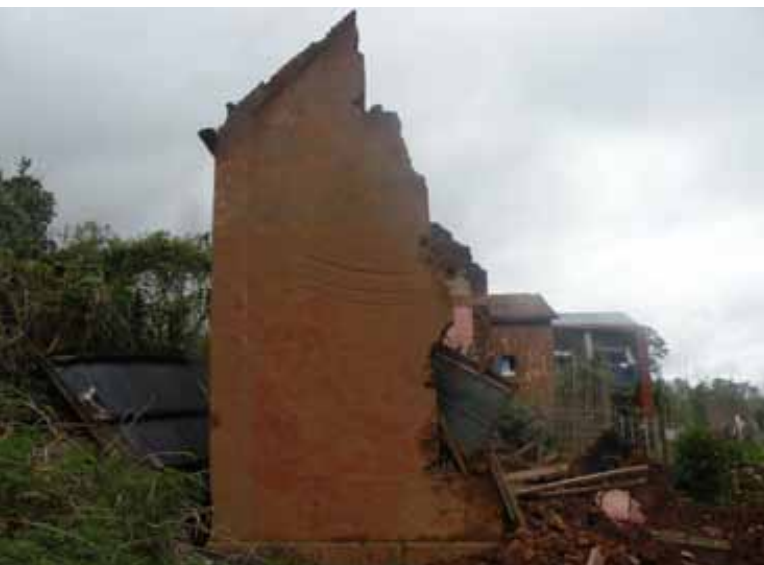
Photo 3 : Maison écroulée partiellement. © Marie Hortense Razafindramboa
