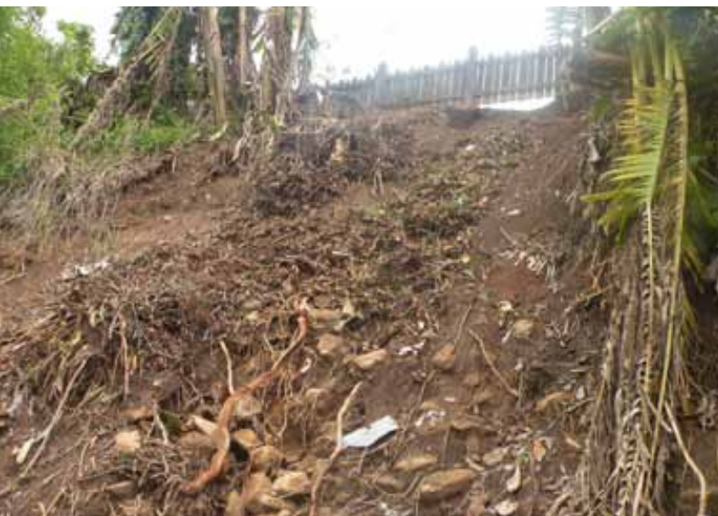
Photo 6 : Talus effondré. © Marie Hortense Razafindramboa
