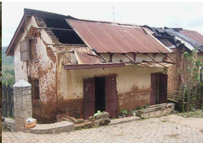
Photo 7 : Toiture emportée. © Marie Hortense Razafindramboa
