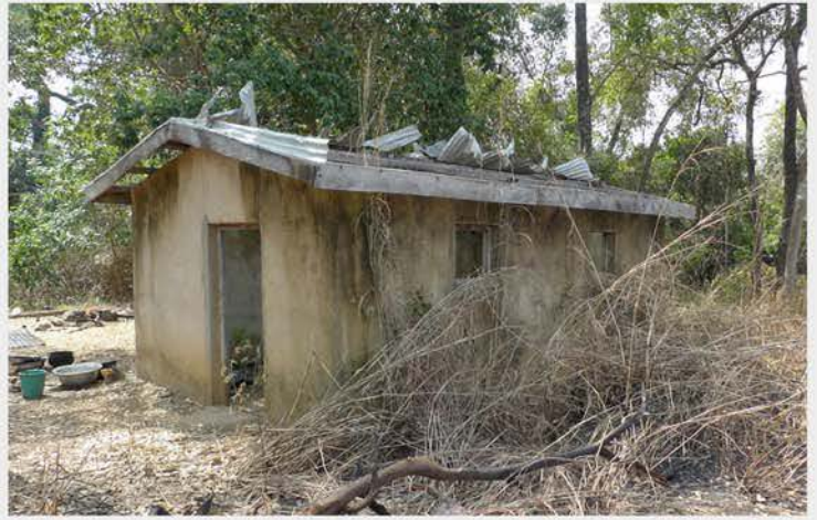
Un des bâtiments délabrés du poste de Gawi
