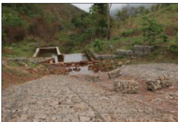
Photo 9 – Dispositif de rétention des matériaux d'érosion, concession SMFG (Source : EMC2I).
