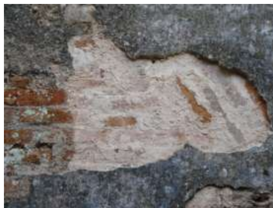
Palais de Sans Souci – Salle d'attente, mur Sud Détachement récent de parties d'enduit.
