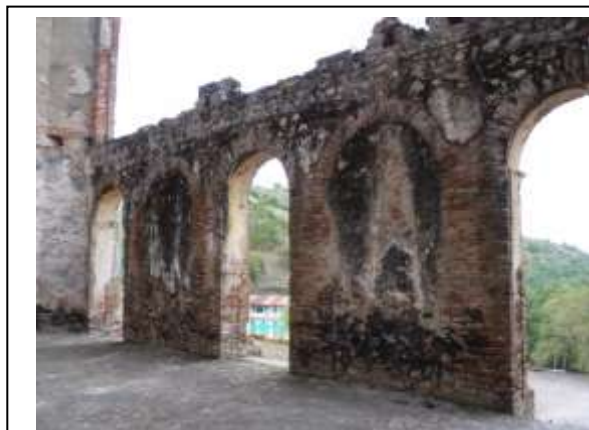
Palais de Sans Souci – Salle d'attente, mur Sud Zone de rétention d'humidité et détachements
