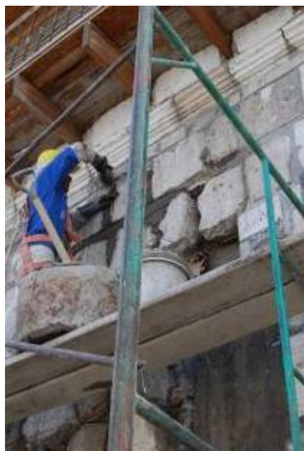
Fig. 2.18. Ocultamiento de un “refuerzo” de hormigón
