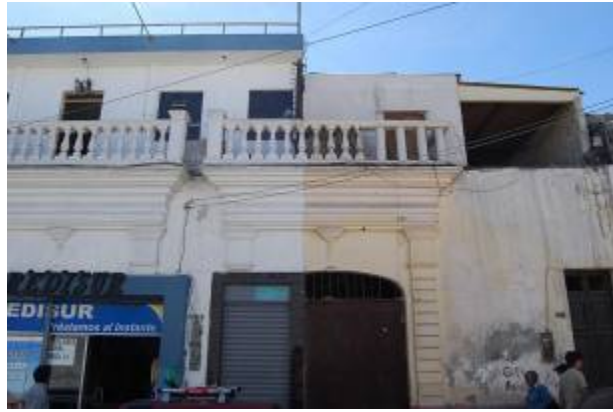
Fig. 2.7. Edificio patrimonial alterado
