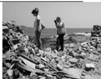
Les experts évaluent les dégâts aux remparts de la Vieille ville de Galle au Sri Lanka
